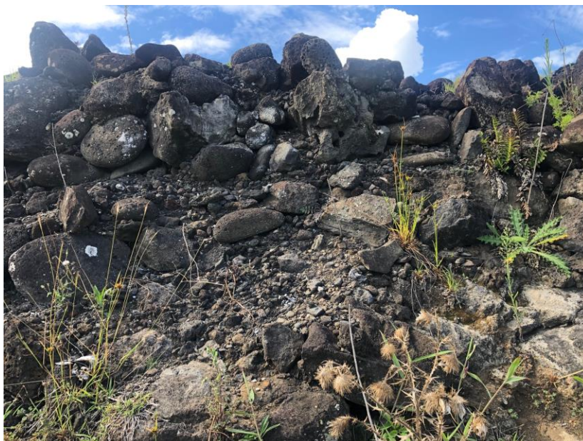
Figura 3.33. Daños presentes en el Ahu Haja Hahave. Fuente: Lya Edmunds.
